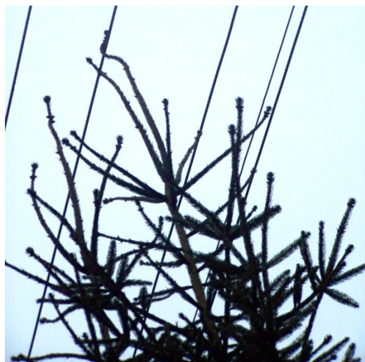
Obr. 15: Smrk zasahující do vedení NN
